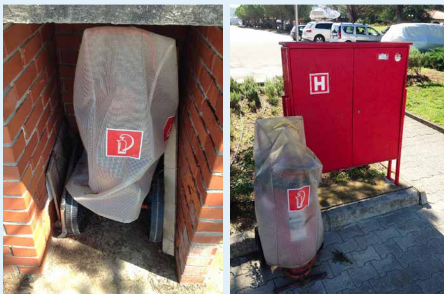
Fotografija 28: Protipožarna oprema
