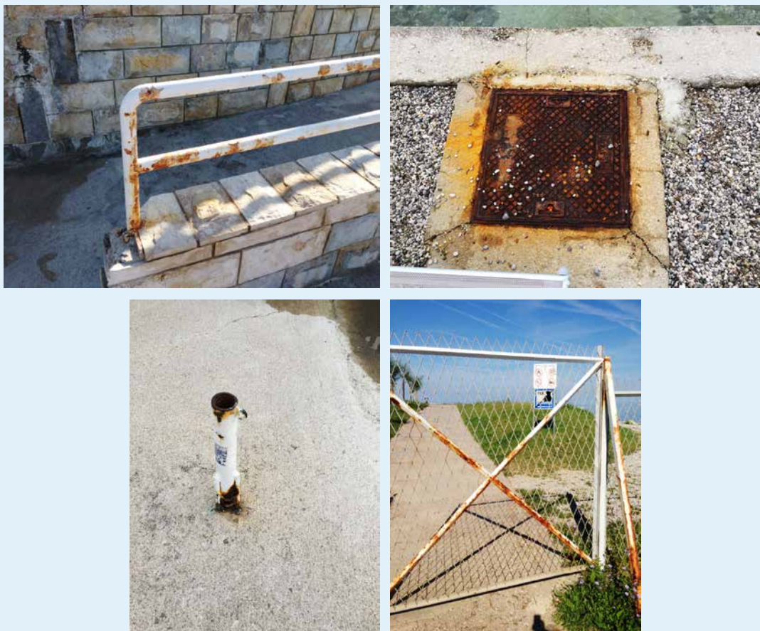
Fotografija 16: Vse kopališke zgradbe in objekti morajo biti redno vzdrževani. Prikazujemo primere slabih praks.
